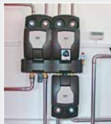
Armaturen im Systemverteiler
